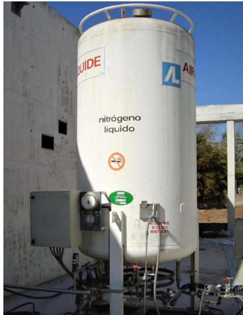
Ilustración 11. Ejemplo de tanque de nitrógeno líquido.
