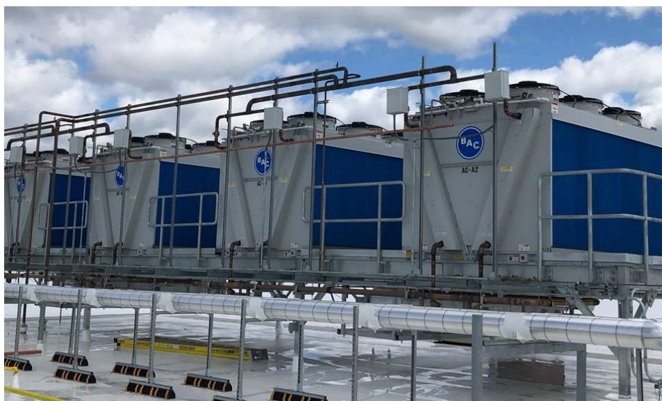
Ilustración 9. Batería de enfriadores adiabáticos.
