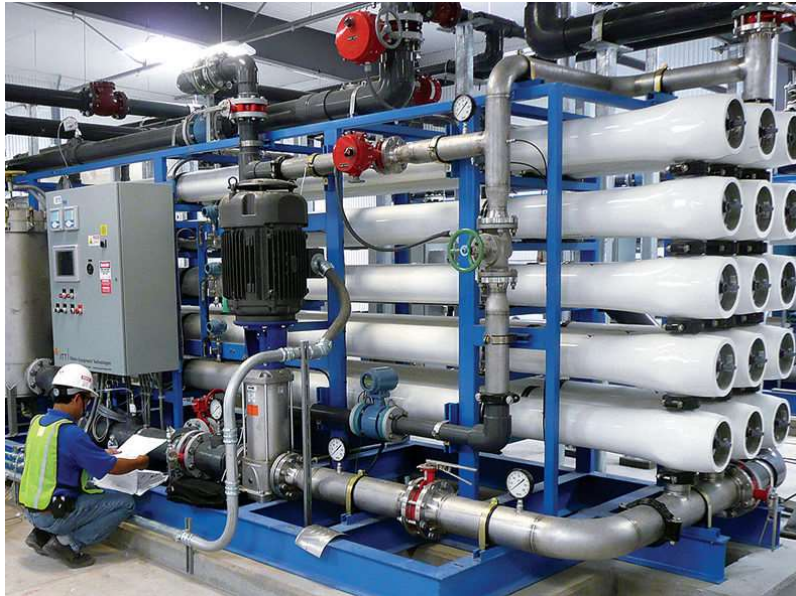
Ilustración 8. Planta industrial de Osmosis.
