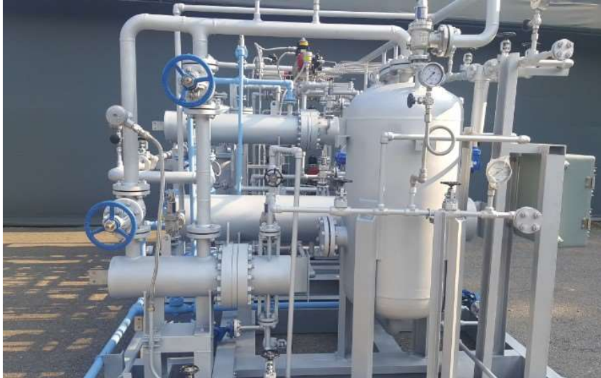
Ilustración 10. Sistema DE-OXO y secado de hidrógeno.
